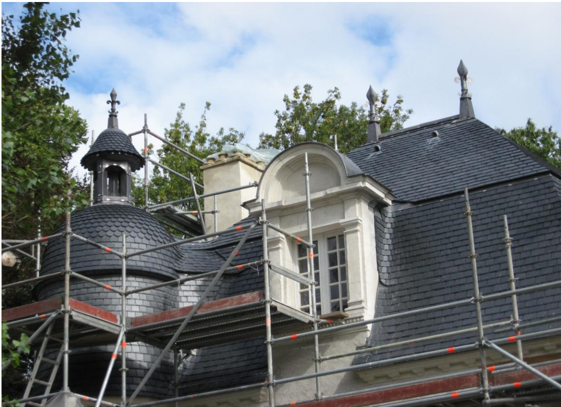
Couverture : pose des ardoises sur le pavillon et sur une des tourelles d'escalier La lucarne en tuffeau porte la date de 1669 Phot. Service valorisation du patrimoine – Ville d'Hennebont – Janvier 2009
